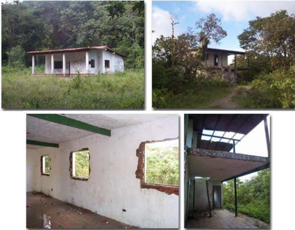
Los puestos de guardaparques de Terepaima se encuentran completamente deteriorados lo cual impide que sean usados para las labores de vigilancia (fotos: César Aponte).
